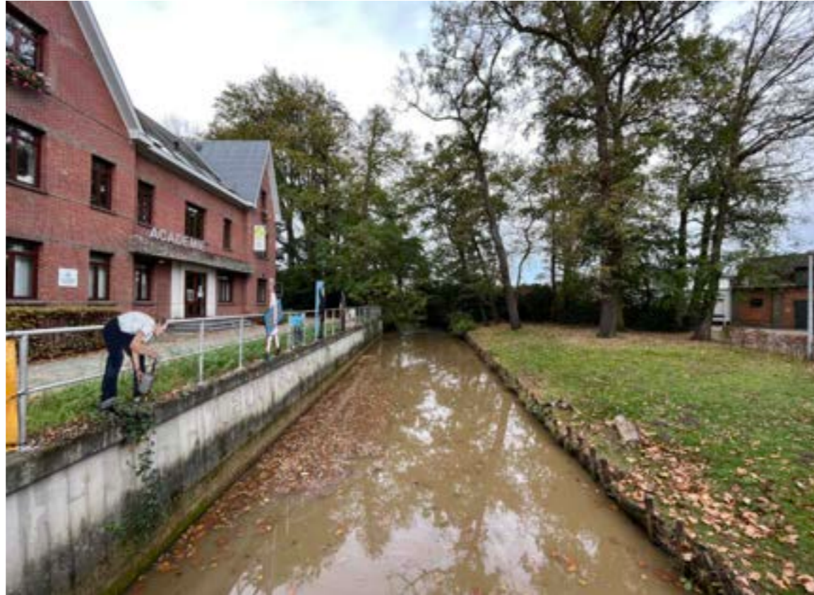
Gracht met betonnen talud vult zich met grond- en hemelwater
